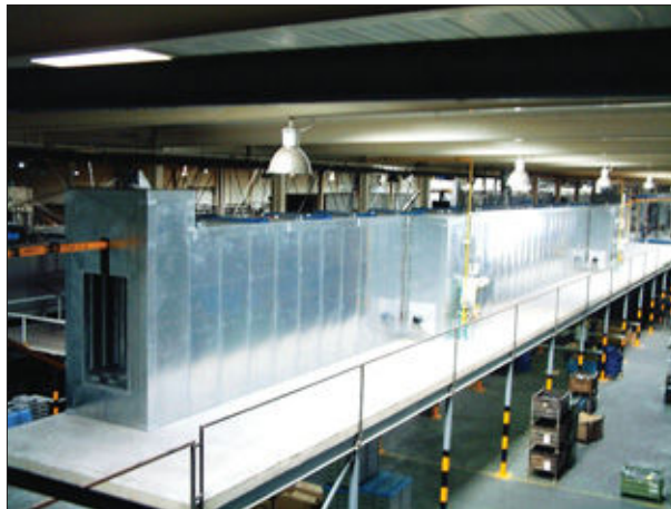
Vista exterior horno de secado de pinturas
