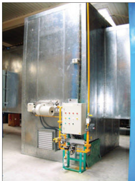
Vista exterior cámara de combustión
