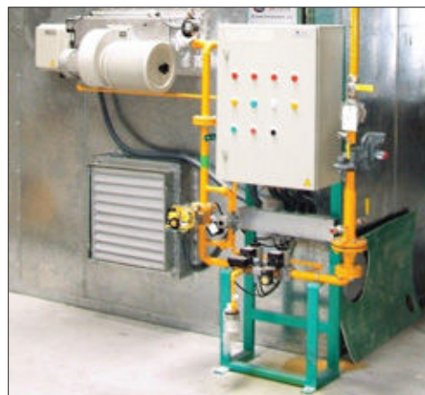
Quemador y rampa de gas
